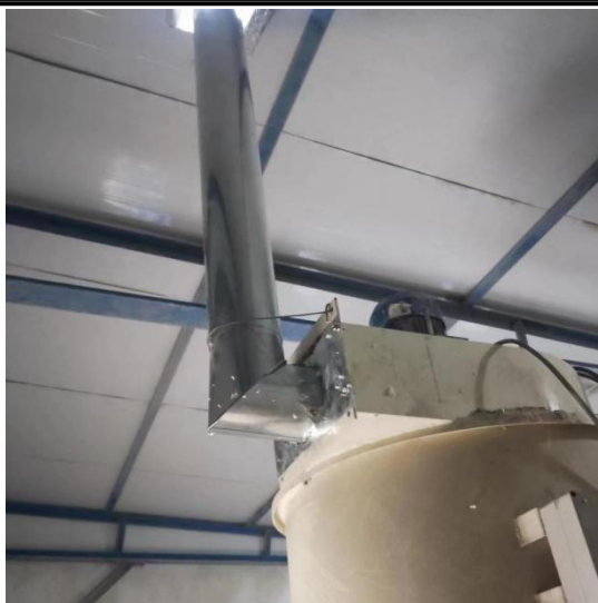
搅拌楼除尘器、排气筒
