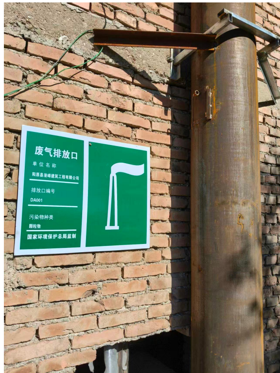
上料废气排气筒（DA001）
