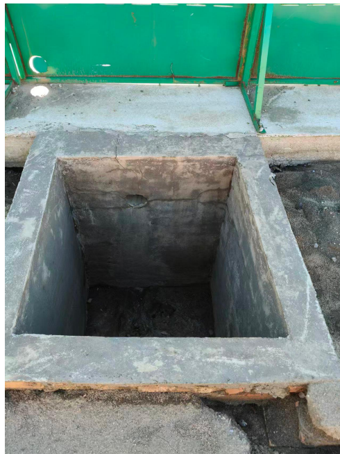
洗车平台配套沉淀池
